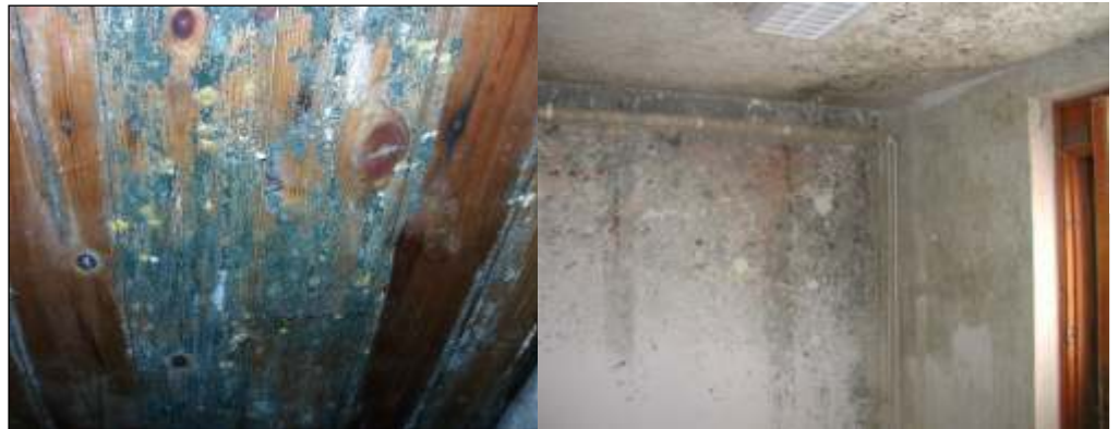
Muggvekst etter vannlekkasje.
