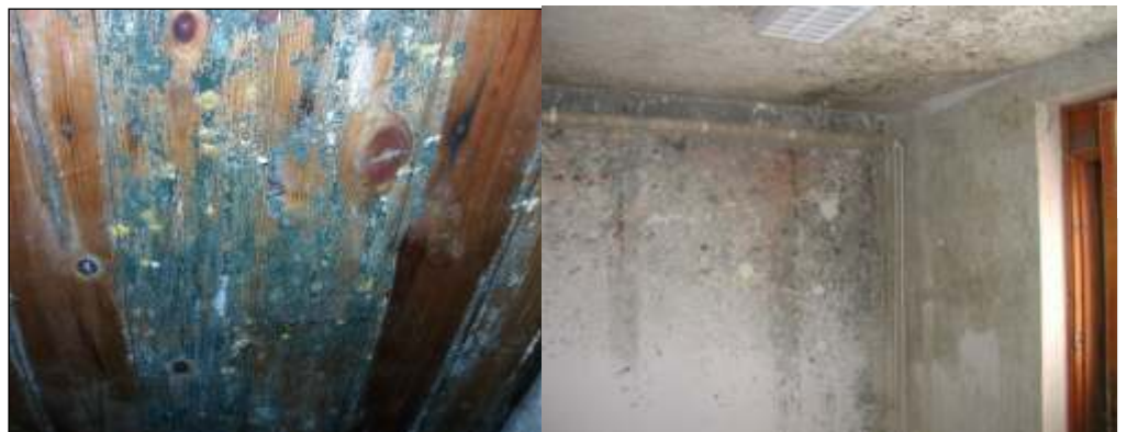
Muggvekst etter vannlekkasje.
